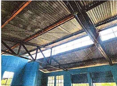
Foto 1: Mantenimiento estructura de techo, en mal estado
