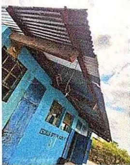
Foto 3: la estructura y cubierta de techo en mal estado
